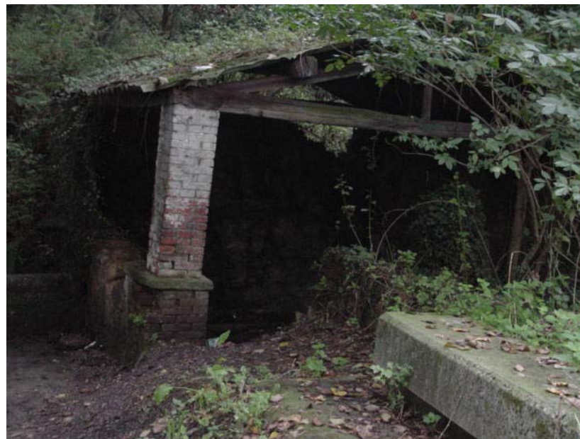
Lavadero y banco.
